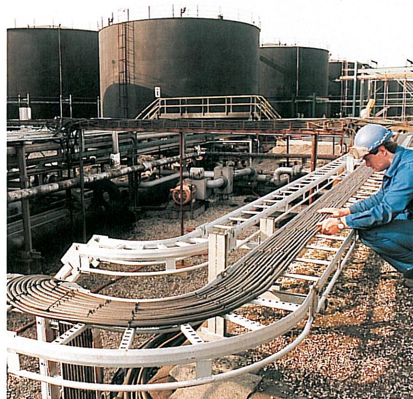
Wibes kabelstegar installeras vid oljeterminalen i Simon Storage i Immingham.
